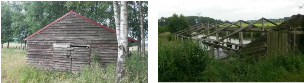
Figuur 3 Het perceel aan de Groningerstraat 21, met op de linker foto het schuurtje wat zich op het perceel bevindt en rechts een foto van het vervallen boothuis.
