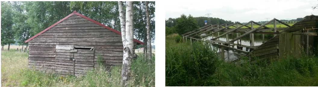
Figuur 3 Het perceel aan de Groningerstraat 21, met op de linker foto het schuurtje wat zich op het perceel bevindt en rechts een foto van het vervallen boothuis.
